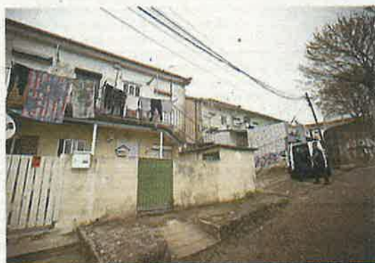
Na Rua dos Currais, casas estão em elevado estado de degradação
